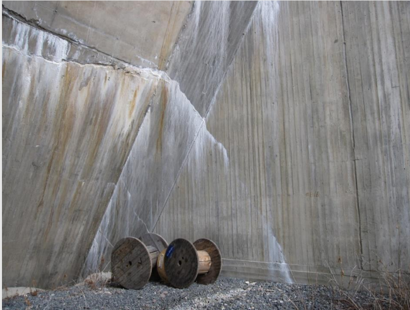
Figur 7 Spricka i frontplatta (till vänster) och i stödpelaren (till höger).
